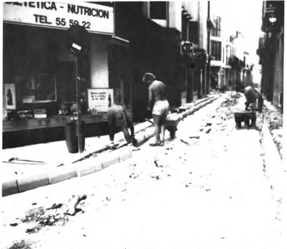
El propietario de la farmacia Ldo. Servera se considera perjudicado por la altura del bordillo de la nueva acera
