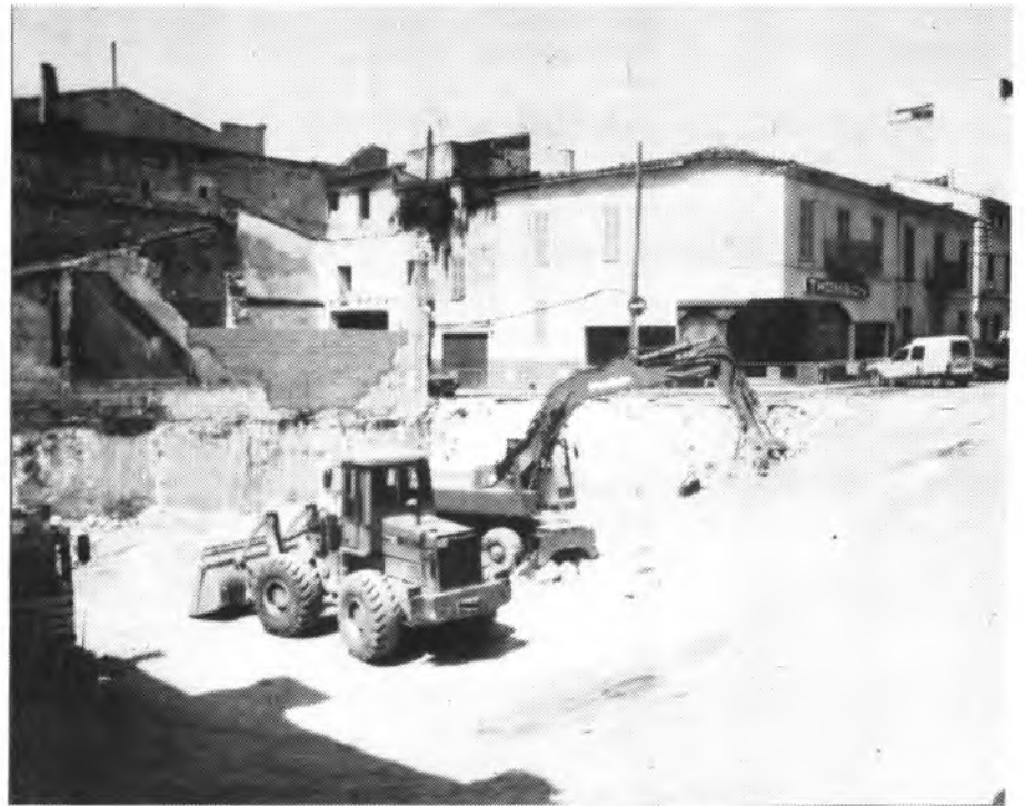
En estos momentos se trabaja en el que será el nuevo edificio
