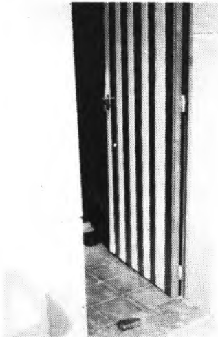
La puerta de la oficina del C.D. Manacor forzada, con la cerradura en el suelo.
