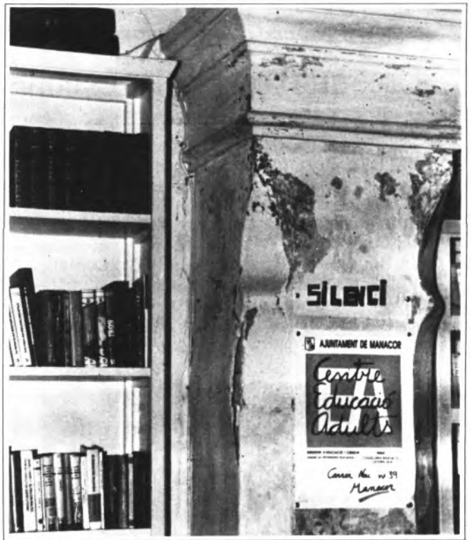
L'edifici es troba en mal estat
