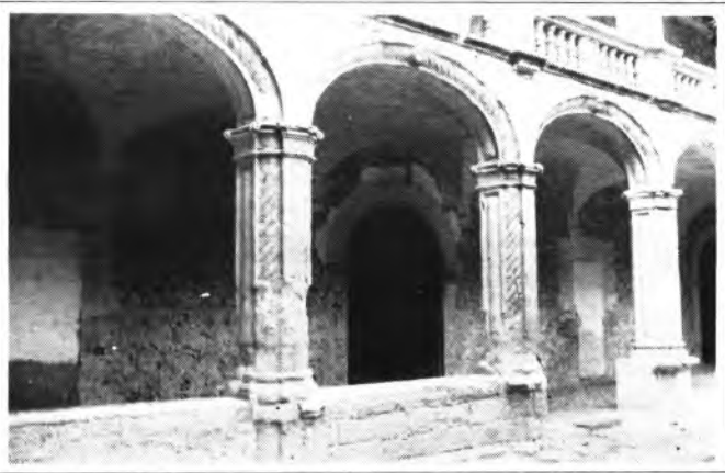
La façana del Claustre una de les reparades pel conveni amb el Govern Balear
