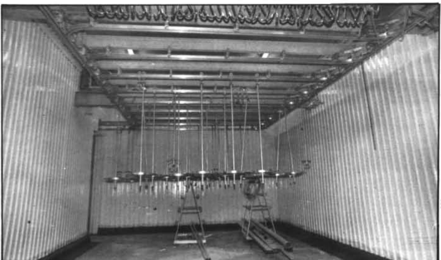
Una de les cambres frigorífiques del nou escorxador.
