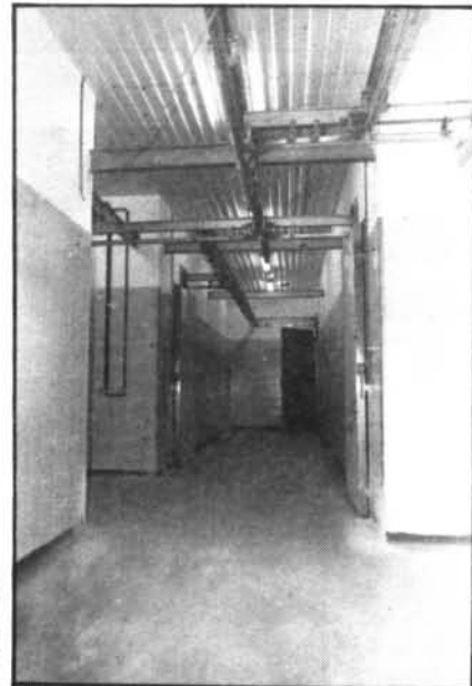
Vista exterior de la zona de cambres frigorífiques.
