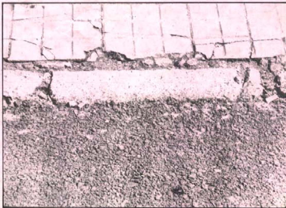
Tantes capes d'asfalt lleven el desnivell propi entre la voravia («acera») i la calçada
