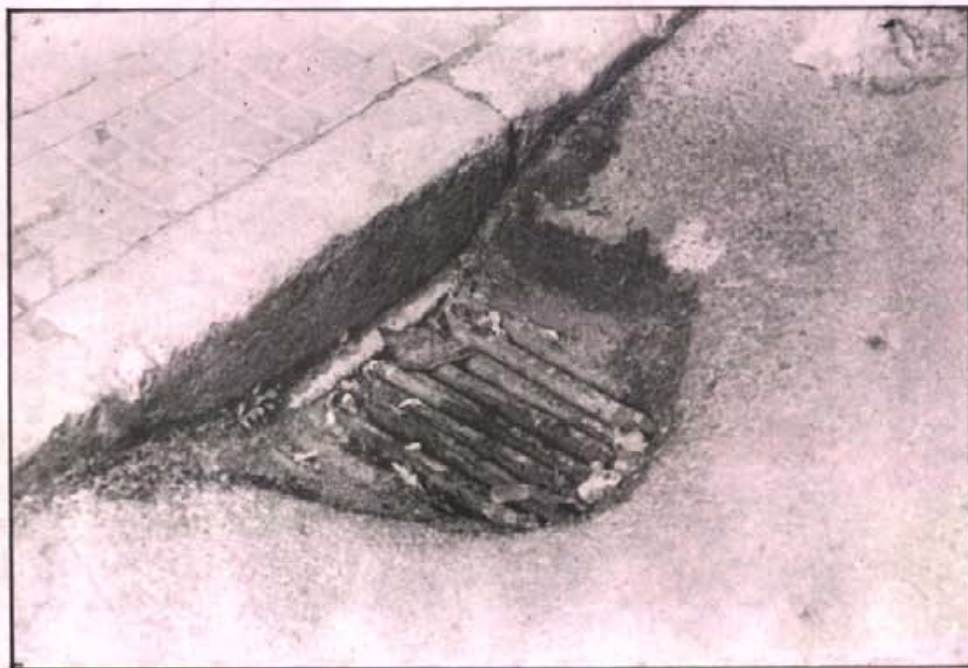
L'asfaltat sobre asfaltat crea els clots artificials o les boques de recollida d'aigua.
