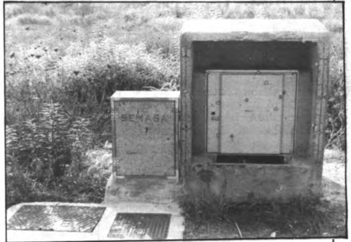
La caseta de l'electricitat per al nou col.legi
