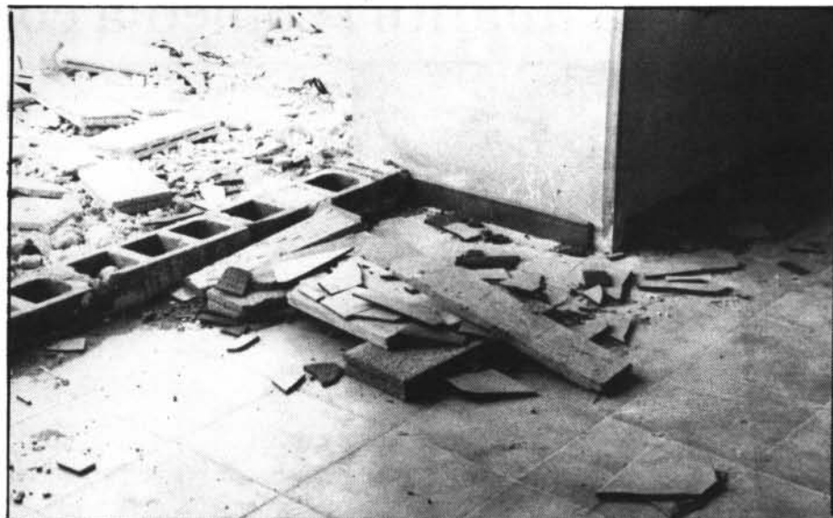
Restes d'obra que destrossen les ratjoles.
