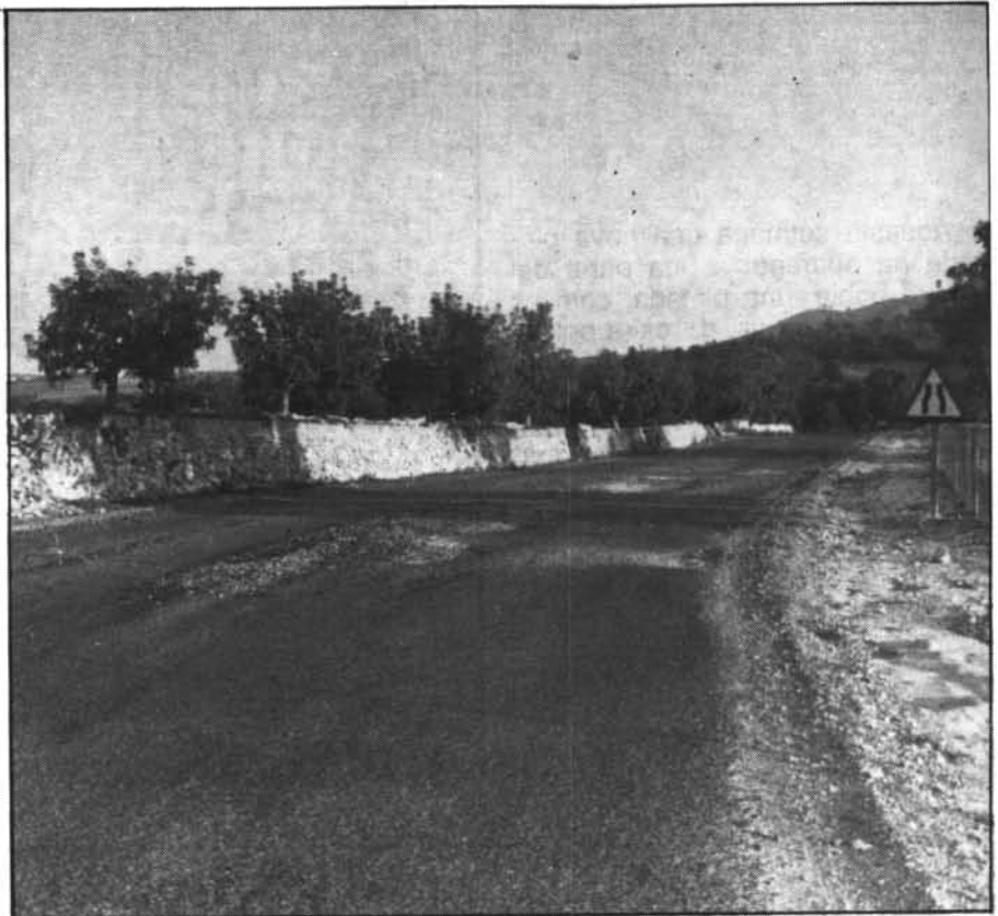
Una vista de la carretera de Son Forteza. Pueden apreciarse perfectamente los baches
