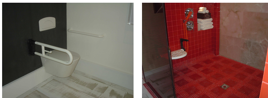
Fig. 75.- Detalles en inodoro (barras y respaldo) y zona de ducha con desagüe central
