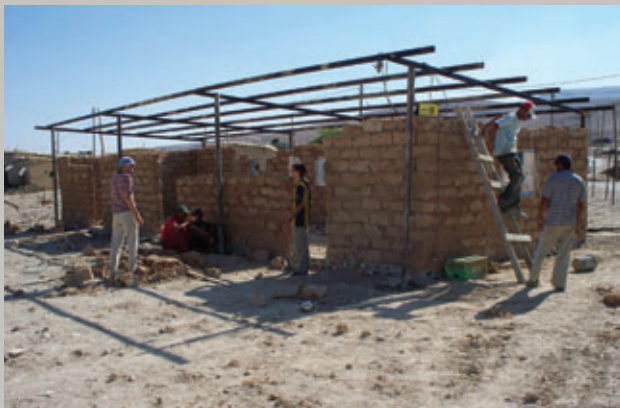
Activistas de la solidaridad de Brighton, Reino Unido, toman parte en la construcción de la escuela en Fasa'i'l.
