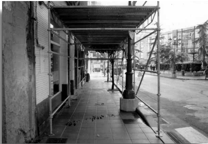
Andamio tubular metálico dejando libre todo el ancho de la calle y con un diseño sin riesgos.
