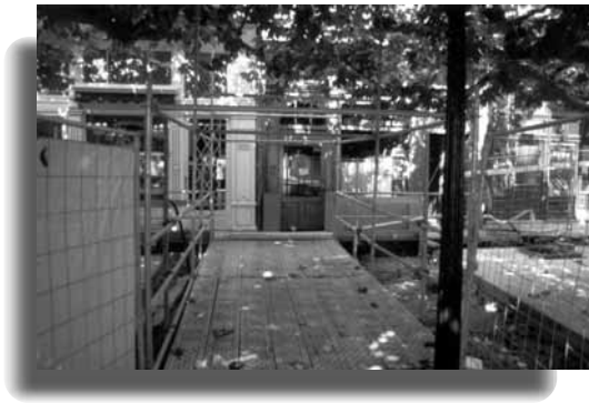
Una gran plataforma salva la zona de trabajos, desarrollándose un pasillo de tablonces de madera para dar acceso a portales y locales comerciales.
