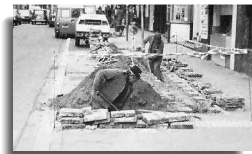
Protección inadecuada de obras.
