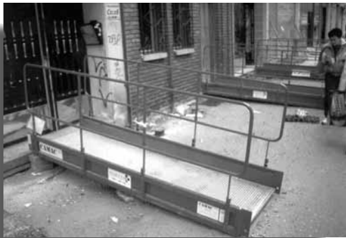
Solución de pasarelas utilizando andamios metálicos colgantes empleados normalmente en la ejecución de fachadas.
