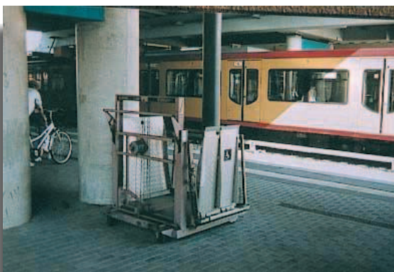
Detalle de plataforma elevadora en andén.
