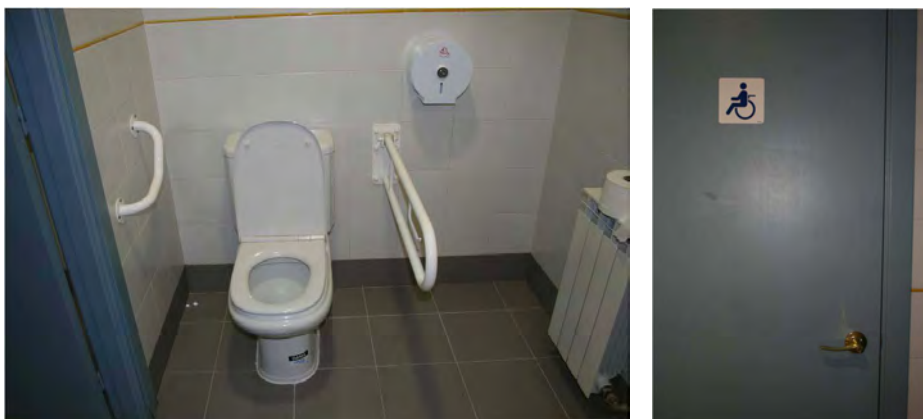
Aseos minusválidos. Puertas de anchura suficiente para paso de silla de ruedas.
