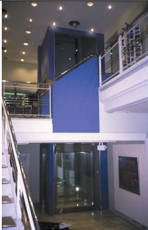
Foto2: Ascensor para comunicación vertical
