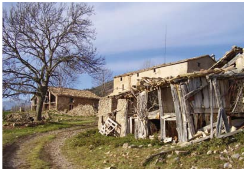
Les masies com aquesta abandonada del Pla de Busa (Solsonès) representen l'esforç d'anys de colonització agrària que ha cristal·litzat en un gran patrimoni construït que avui es fa difícil de mantenir. Sumen a través dels seus diversos edificis una gran quantitat de metres quadrats que compliquen una recuperació estrictament residencial i fan més avinent un programa d'usos turístics o de serveis en general. (Foto: I. Aldomà)
