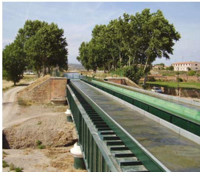
Els canals d'Urgell representen l'àrea regada més gran del país i amb la seva aigua s'abasteix també un gran nombre de poblacions i indústries. L'aqüeducte o pont de ferro del canal d'Urgell sobre el riu Sió (Agramunt, Urgell) construït el 1875 és tot un símbol del valor patrimonial que tenen també les infraestructures aparellades als grans sistemes de regadiu. (Foto: I. Aldomà)
