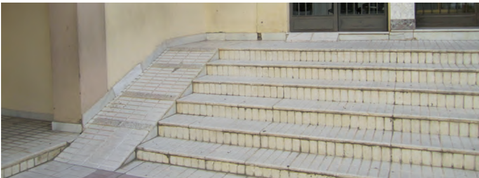
Imagen 146. Rampa inaccesible de un edificio residencial.
