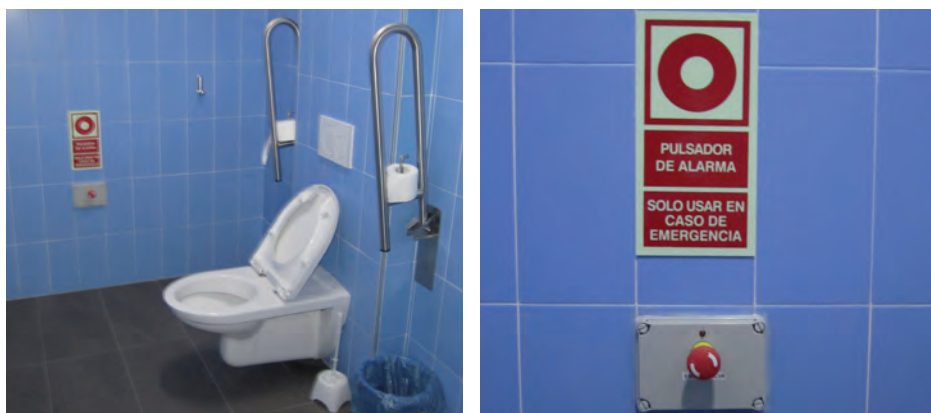
Imágenes 203 y 204. Pulsador de alarma de emergencia ubicado en un aseo.
