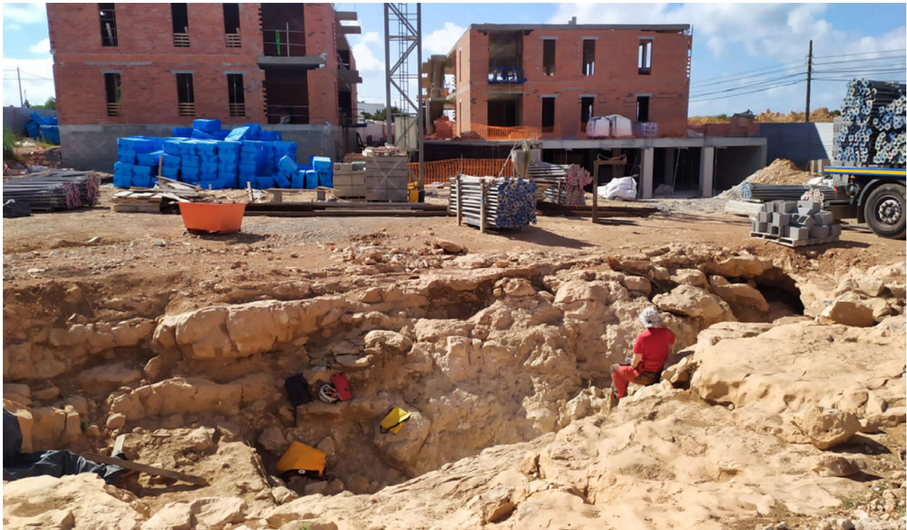
Figura 1: Esfondrament d'Entrada una vegada rebaixat el nivell del terra per maquinària pesant i després de l'excavació arqueològica que ha descobert les dues entrades a la cavitat. Es pot apreciar l'avanç de les obres dels blocs d'habitatges al fons (Foto: F. Gràcia). Figure 1: Entrance collapse depression once the ground level was lowered by heavy machinery and after archaeological excavations that have unclogged the two entrances to the cavity. The progress of buildings' construction can be observed in the background (Photo: F. Gràcia).
