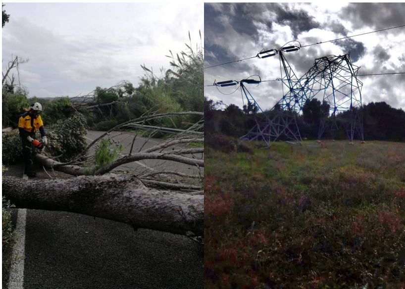
Figura 33. Arbres tombats sobre vies de comunicació (esquerra) i línies elèctriques greument afectades (dreta).
