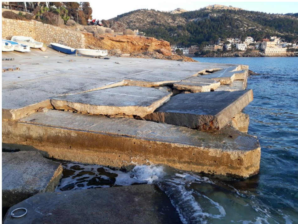
Fig. 26. Moll de Sant Elm (Andratx) destruït després del temporal Glòria.
