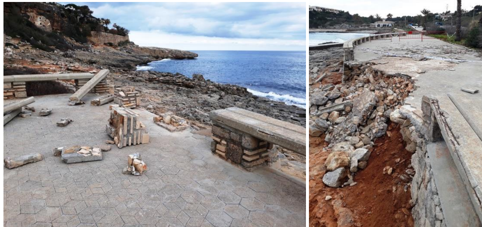
Figs. 20 i 21. Efectes del temporal Glòria sobre el passeig marítim de cala Murada (Manacor). Figs. 20 and 21. Effects of the storm Gloria on the promenade of Cala Murada (Manacor).
