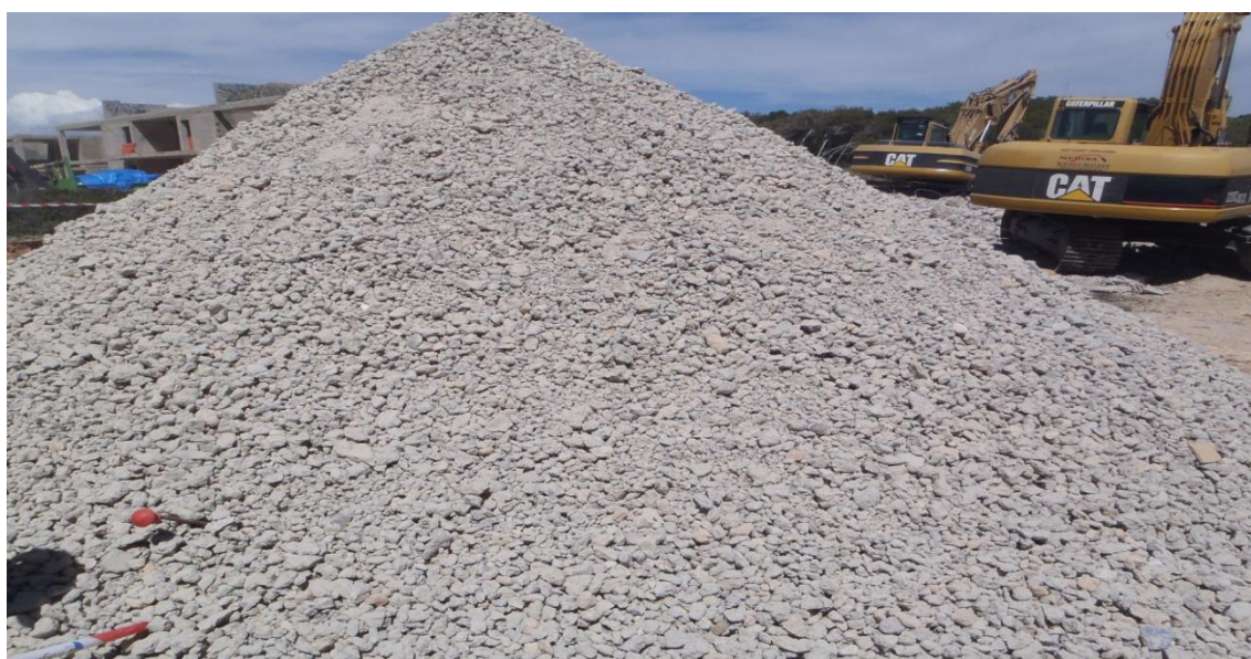
Fig. 14. Dipòsit temporal residus construcció i demolició, fracció formigó Codi LER 17 01 01 abans de la seva valorització “in situ” mitjançant rebliment de zones excavades de la demolició
