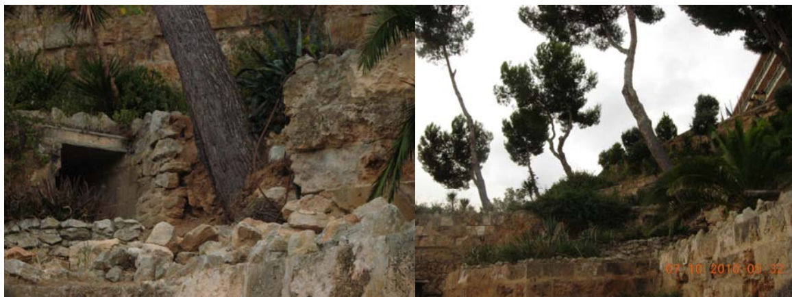
Figuras 44 y 45. Vista del pino peligroso sobre Cala Fornells
