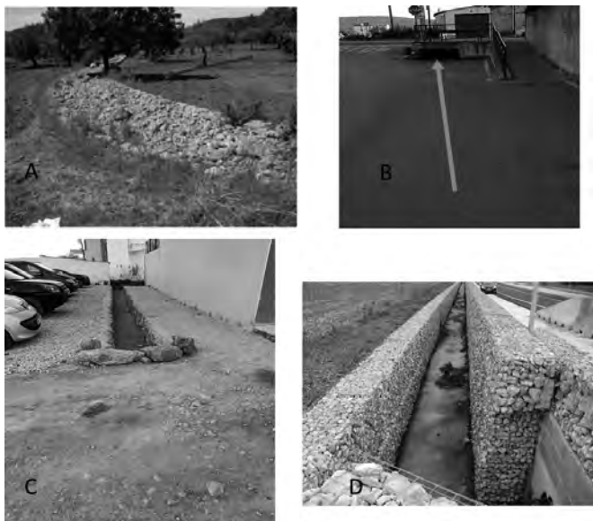
Figura 5: A, marjades a Es Cabàs de mitigació d'escorrentia; B, col·lector d'aigües del camí de Coanegra; C, síquia colmatada al límit est del nucli de població (vial); D, gabions de conducció cap a un estany de retenció al nou accés a l'autopista Ma-13 vora Son Llaüt.
