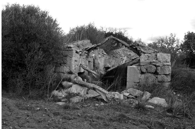
Aspecte de la part frontal en mal estat de la barraca.
