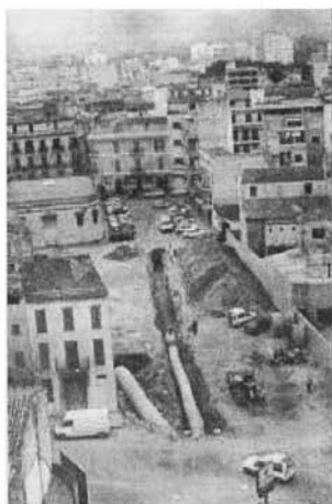
Figura 5.- Canalització del torrent de Cantabou al mateix lloc que la fig. 4. Font: setmanari Dijous. 1991
