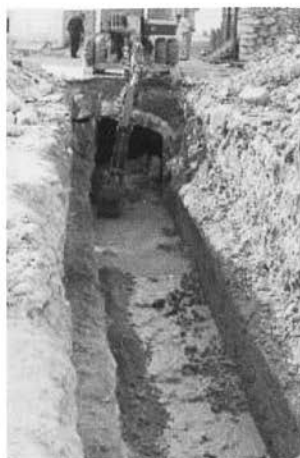
Figura 4.- Obres al llit del torrent de Cantabou a la cruïlla dels carrers de Luque i Gran Via al 1982.
