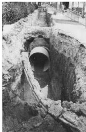
Figura 6.- Canalització del torrent de Cantabou al mateix lloc que les figures anteriors, però al 1999.
