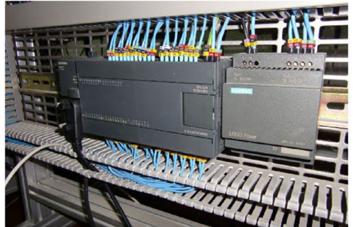
Figura 1. PLC que controla la subestació de Bases.
