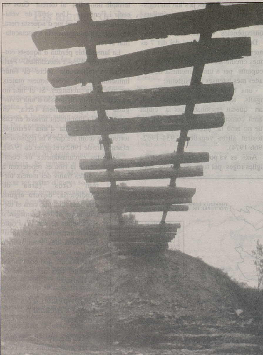
La via del ferrocarril d'Inca a sa Pobla just devora l'estació de Muro. El pont que havia de permetre el pas al torrent que ve d'Inca no va ésser suficient i la pressió de l'aigua va arrasar el terraplè. És tal vegada la imatge més repetida a l'hora d'informar sobre les inundacions d'enguany. (Fotos J.Eugeni Pons).
