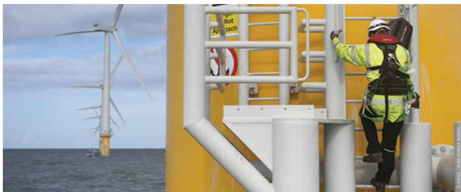
imagen TÉCNICO ASCIENDIENDO UNA TURBINA EÓLICA EN BURBO BANK, LIVERPOOL, REINO UNIDO.
