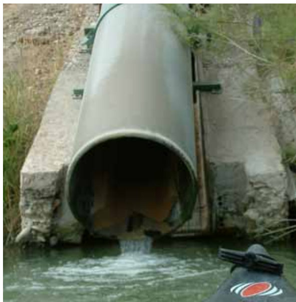
Tubería de vertido al Ebro en las inmediaciones de la factoría de Flix, en Tarragona.
