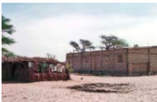
La nova escola en procés de construcció. La nueva escuela en proceso de construcción.
