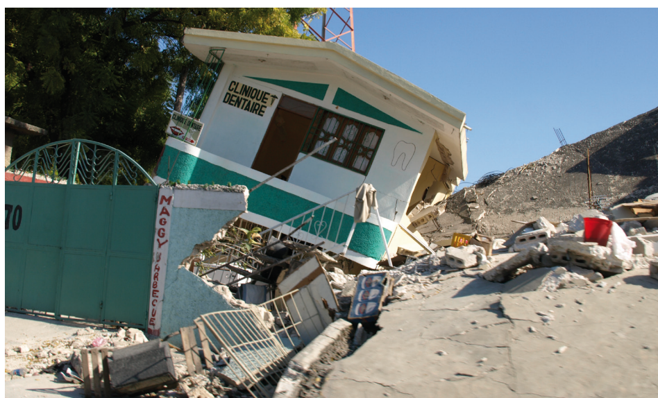
Clínica afectada. Terremoto. Haití 2010
