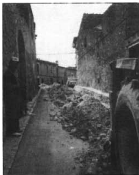
Han començat les obres per a la canalització d'aigua potable. Els aqüífers subterranis encara disminuiran
