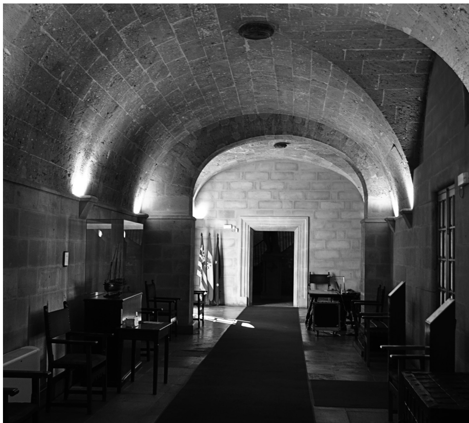
Fig. 12 Jaume Blanquer (traça), Antoni Torrents (constructor). Palma, Consolat de Mar. Galeria de la planta baixa, 1614-1615
