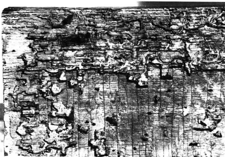
Estado inicial: Reverso de lateral donde se aprecia el lamentable estado del soporte
