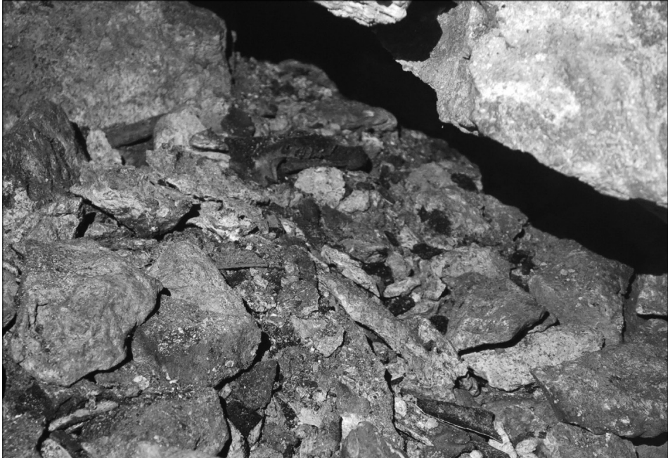
Fig. 6 Detall de nivells superficials sota les lloses caigudes
