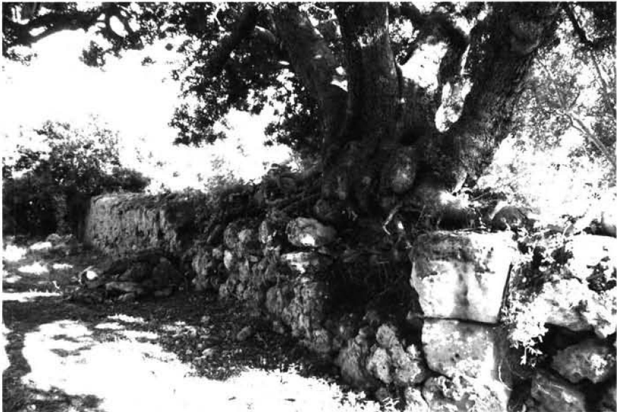
4.- Estat del parapet de l'estrada encoberta del castell de Bellver.
