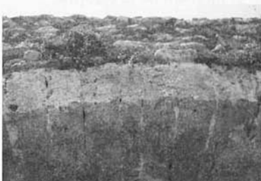
Figura 17.- Clau de la volta de mig punt, més estreta que la resta de dovelles
