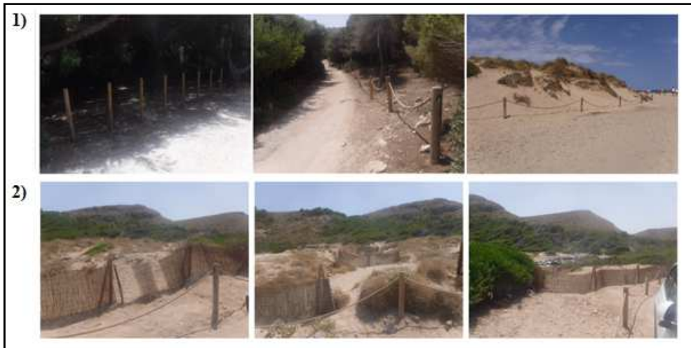
Fig. 6. Localització dels (1) cordons dissuasoris i (2) trampes d'interferència eòlica al sistema dunar de Cala Torta.
