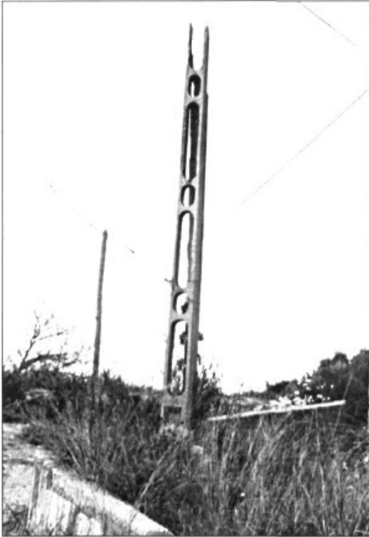
La caiguda d'un cable elèctric per mor del vent provocà un accident devers el Sortidor.
