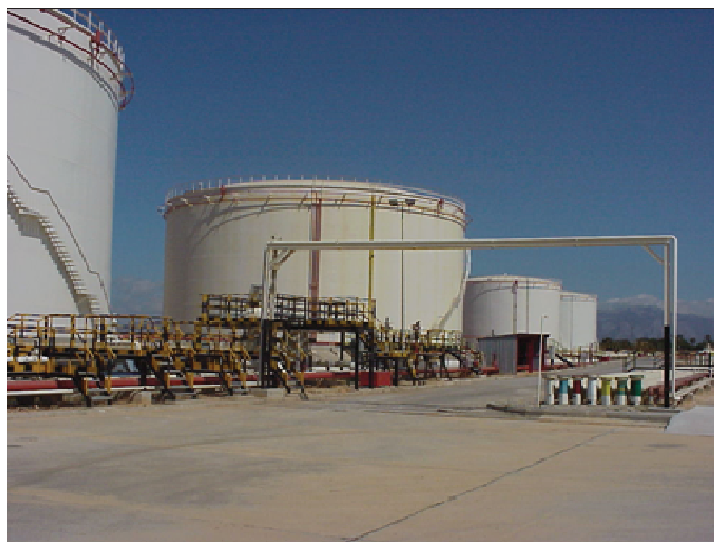
Fotografía 2.1. Almacenamiento de líquidos inflamables de la compañía CLH.
