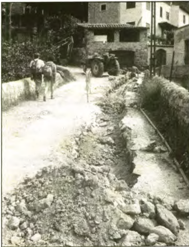
El camí està construït damunt pedreny i ha causat nombrosos esbucaments.
