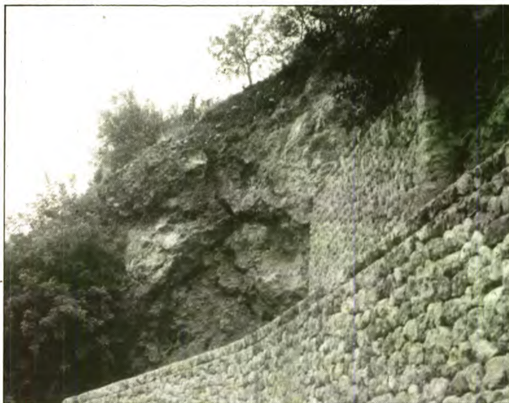
Fa pocs anys es varen construir tres marges de pedra reforçats amb ciment per evitar l'esllavissament de terres. Ara s'ha produït un nou crull.
