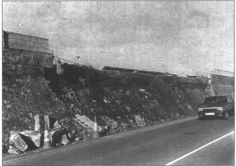
— Situat a la carretera de sa Colònia un enterrossall de la paret de Sa Pista
