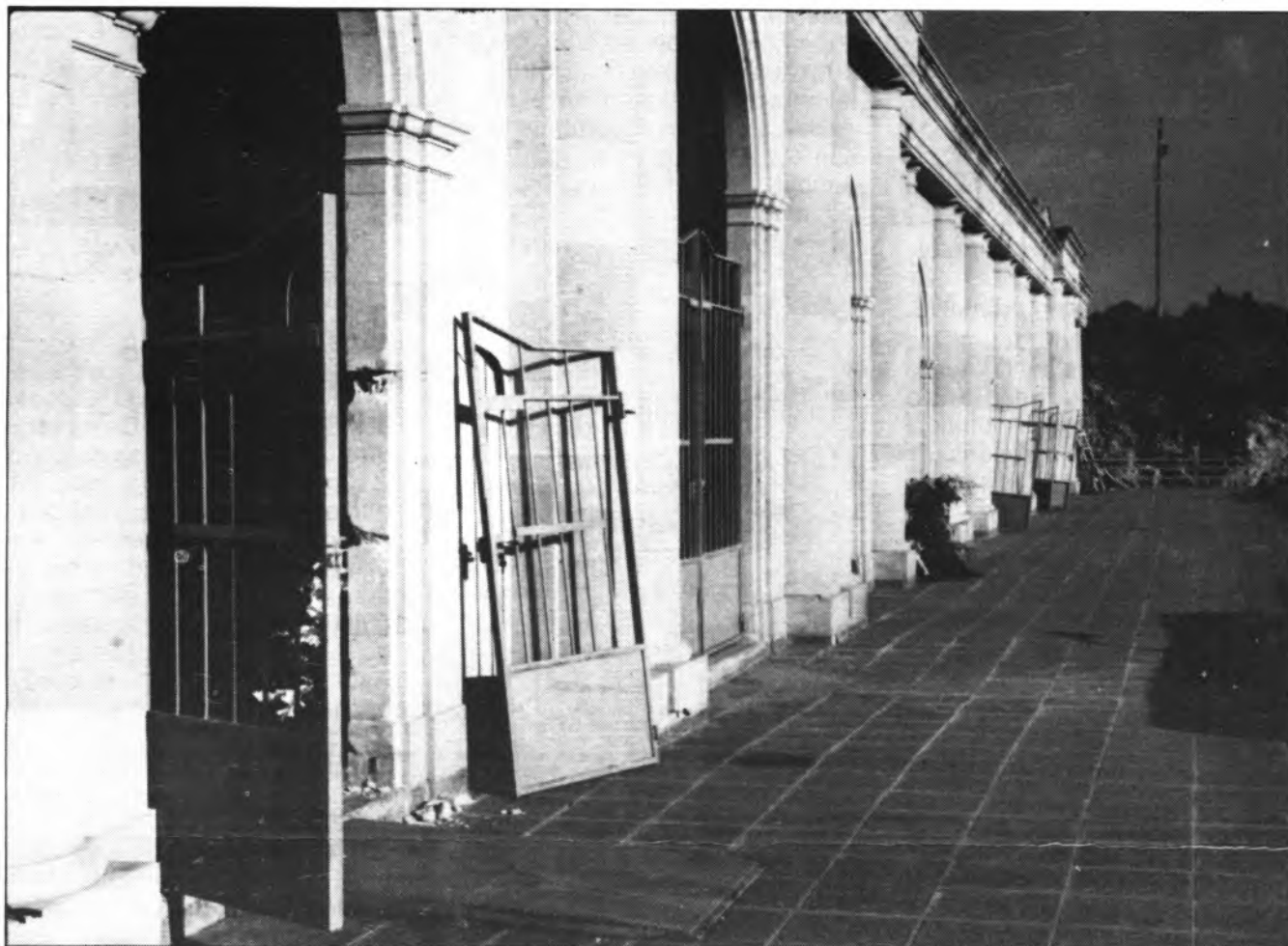
Todas las puertas de la zona superior se han desprendido de sus enclavamientos
