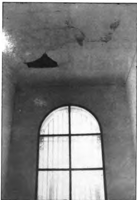
El techo del depósito de cadáveres, en estado lamentable
