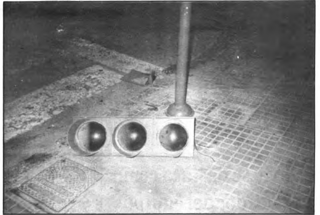
Los semaforos de la calle J. Armengol, destrozados por el fuerte viento del pasado viernes (FOTO: ANDRES QUETGLAS).
