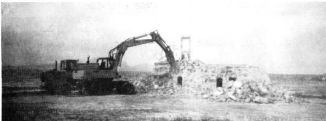
El Nido de ametralladoras de la calle Cervantes ha sido demolido, quedando ahora para la plaza del Obelisco un amplio horizonte y un mar más cercano
