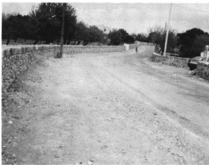
La anchura de la carretera del Mas Pas ha quedado visiblemente modificada y aumentada. Falta ahora la segunda fase que consistirá en la colocación de su asfalto
