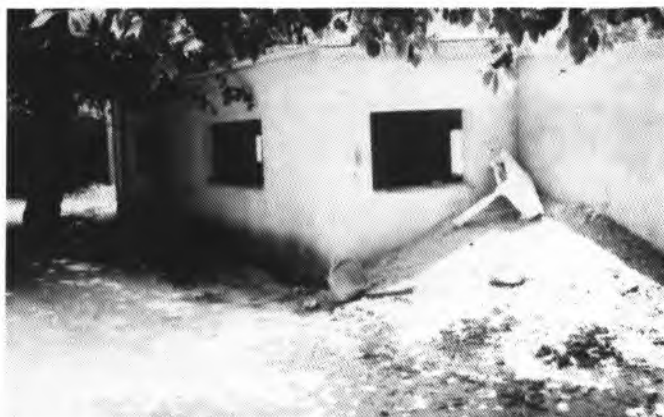
Montones de basura y falta de mantenimiento es una de las deficiencias más significativas de la Instalación Municipal
