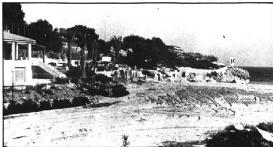
Les obres no tenen llicència municipal
